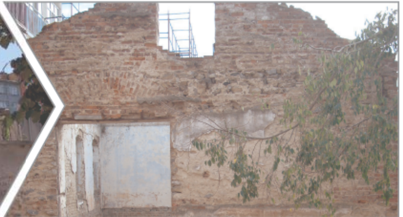
125 Ada 66 Parsellerdeki Tescilli Kagir Yapı'nın Rölöve, Restitüsyon ve Restorasyon Projesi (Rölöve Projesi Koruma Kurulu tarafından onaylanmıştır.)
